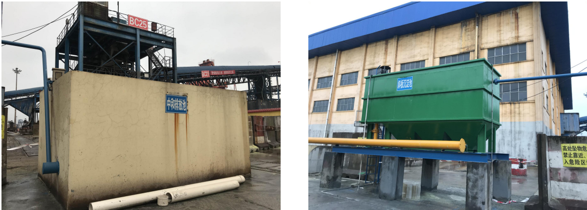
图 5.2-7 15#泊位含磷污水处理站现场照片
