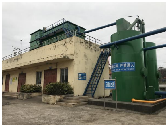
13#泊位含尘污水处理站
