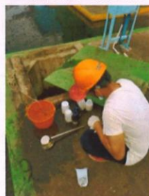
407 泊位污水站清水池
