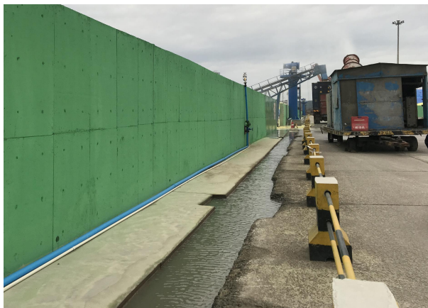
14#硫磺堆场排水明沟
