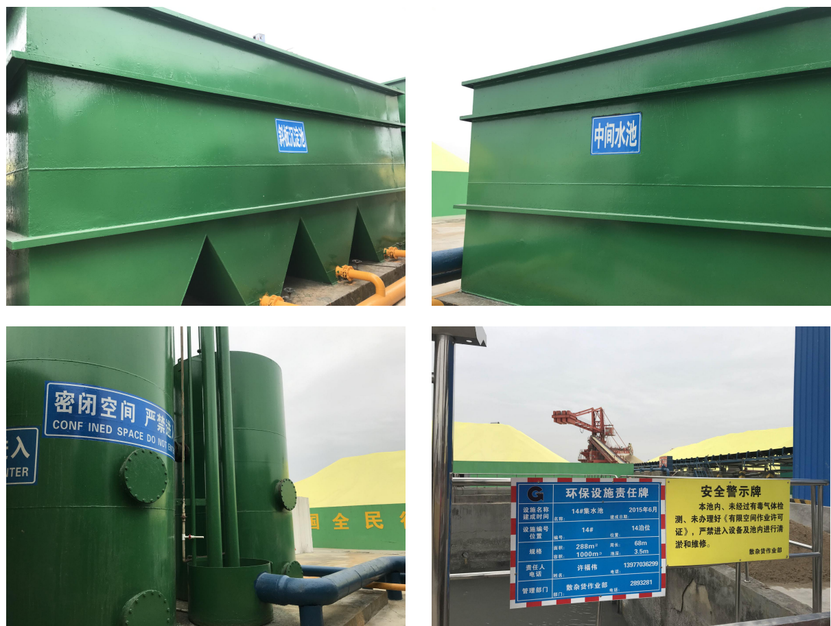
图 5.2-6 14#泊位硫磺污水处理站现场照片
