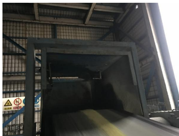
14#装箱楼喷淋系统
