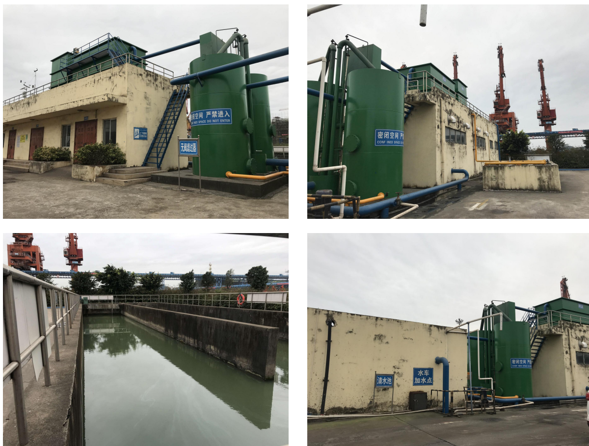
图 5.2-5 13#泊位含尘污水处理站现场照片
