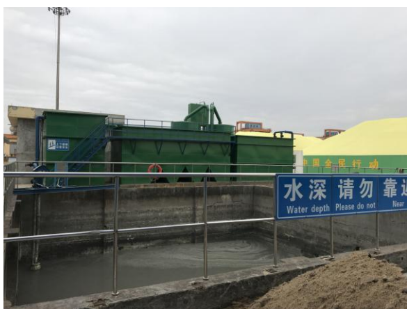
14#泊位硫磺污水处理站
