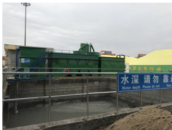
第 14#泊位硫磺污水处理站
