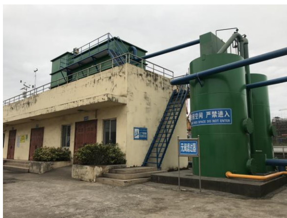
第 13#泊位含尘污水处理站
